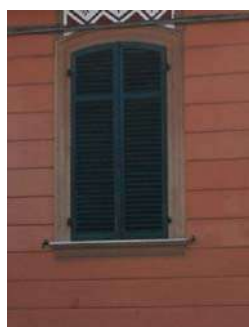
TIPO 8E) AD ARCO RIBASSATO CON DUE ANTE E APERTURA VERSO L'ESTERNO
