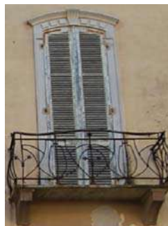
TIPO 8T) A DUE ANTE CON APERTURA VERSO L'ESTERNO AD ARCO RIBASSATO
